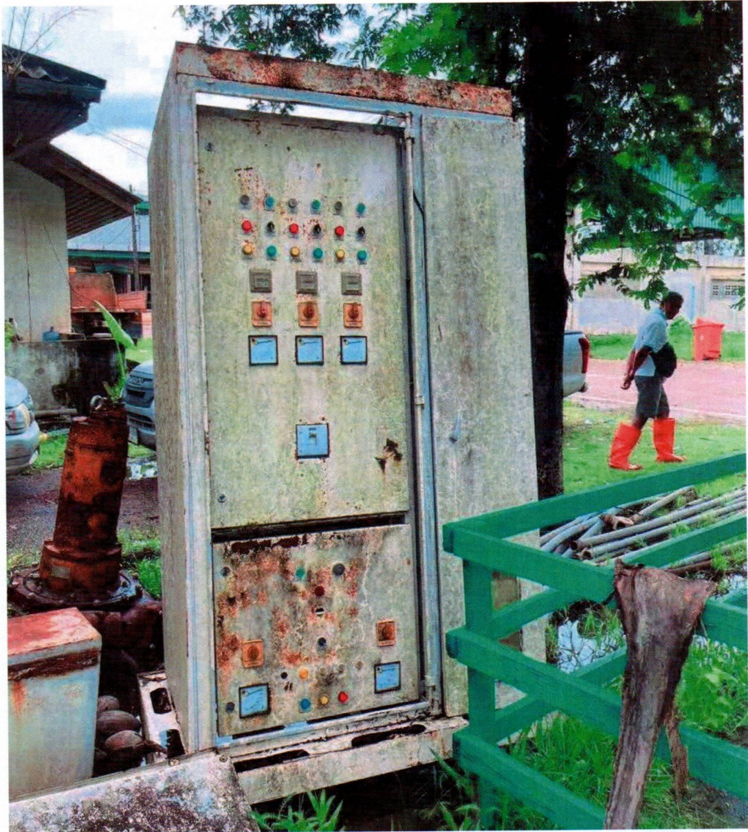
ตู้ควบคุมไฟฟ้า จำนวน 1 ชุด
