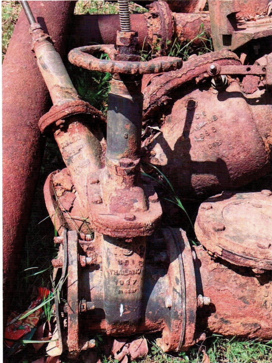
GATE VALVE ตัวที่ 2
