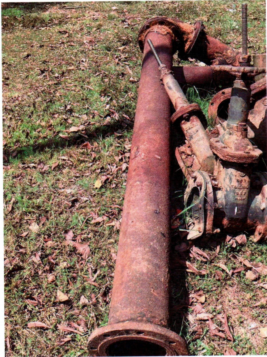
ท่อเหล็ก ท่อนที่ 1
