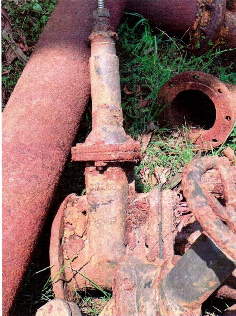
GATE VALVE ตัวที่ 1
